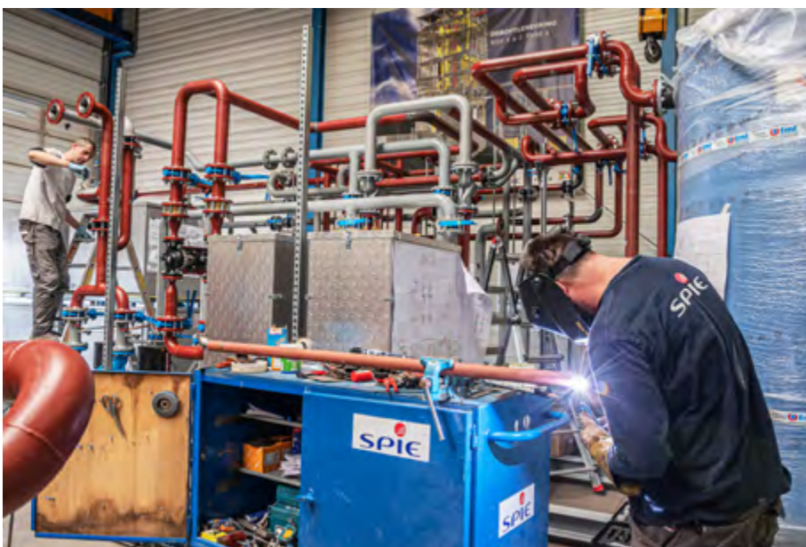
Bij Spie in Elsloo wordt op dit moment het Mijnwater skid voor het Kindcentrum gebouwd. Een skid is een installatie voor procestechniek die op een frame is gemonteerd. Het gehele frame wordt straks in 1 keer naar Heerlen getransporteerd. (Foto Mijnwater B.V.)
